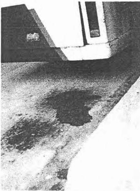
Contaminación y deterioro del pavimento asfáltico
