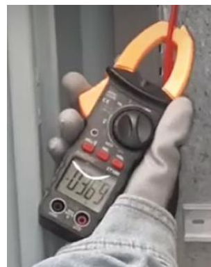
Figura 71. Medición de corriente amperímetro de gancho.
