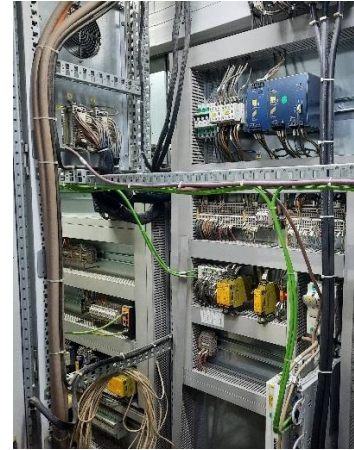
Figura 4. Tablero eléctrico. Fuente: Bio Pappel TITAN planta Guadalajara.
