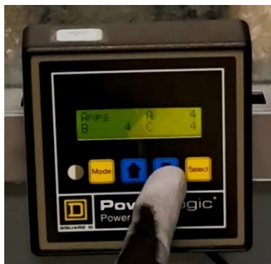
Figura 70. Medición de corriente con medidor PM650.
