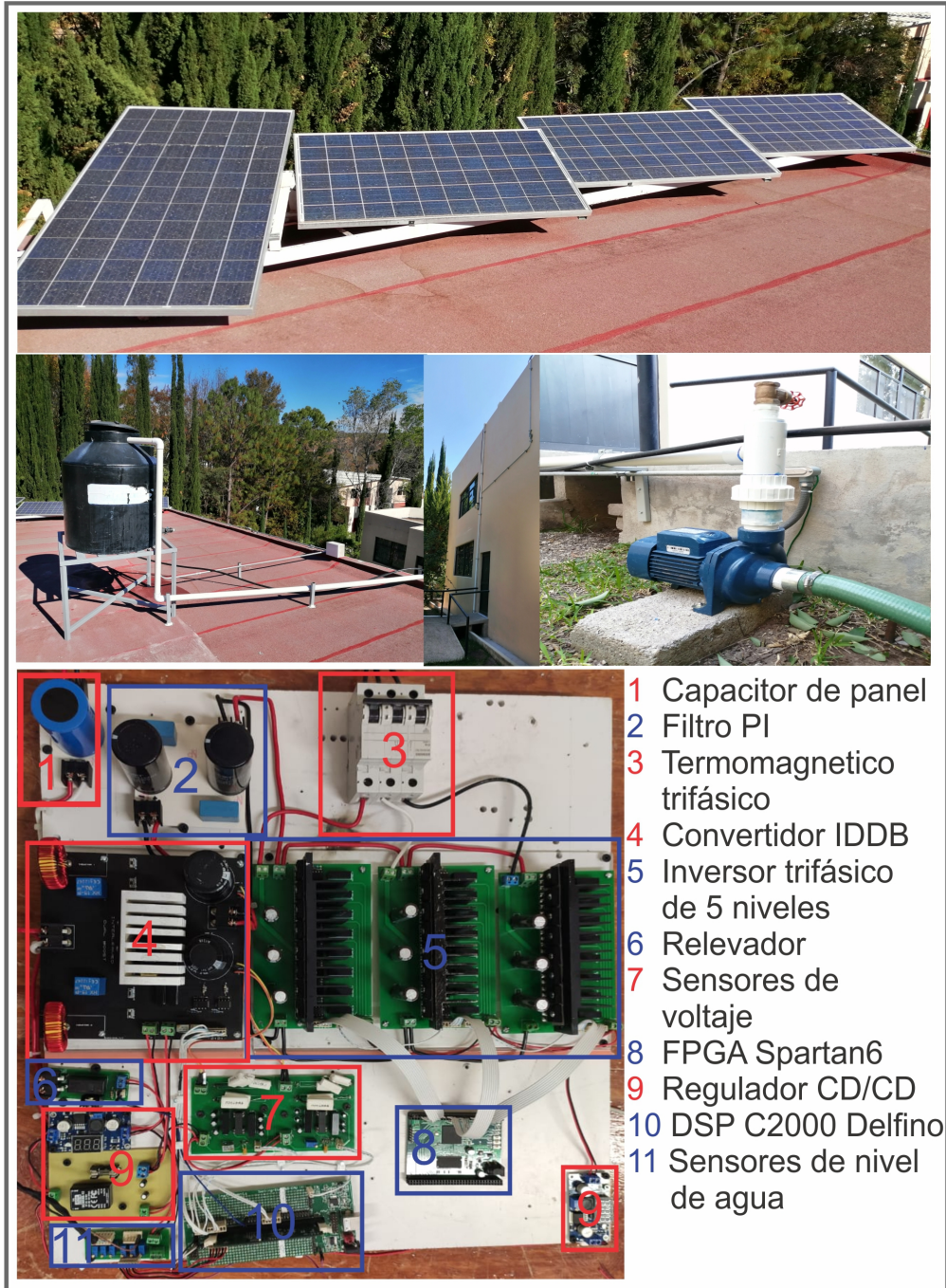
Figura 4.2: Sistema de bombeo solar instalado en el laboratorio de posgrado de la UTM.
