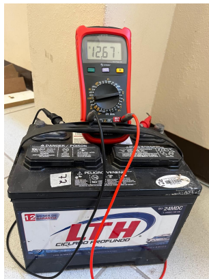
Figura 3.3: Voltaje de la batería en vacío.
