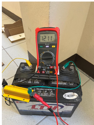
Figura 3.5: Voltaje de la batería con carga.
