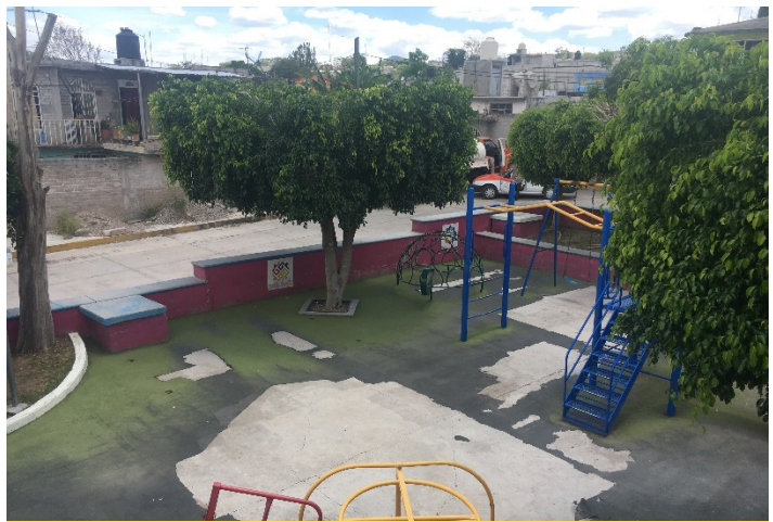
Figura 31. Deterioro de suelo y pintura en el área de juegos infantiles Fuente: Fotografía propia, 2019.
