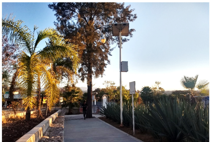
Figura 16. Lámparas con celdas solares en el Parque Bicentenario. Fuente: Fotografía propia, 2019.
