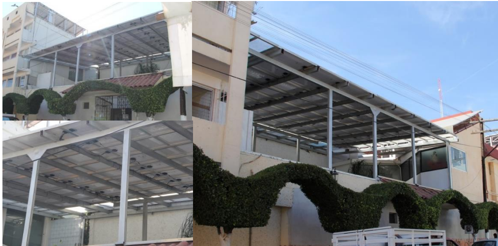
Figura 2 Edificación con la implementación de un sistema fotovoltaico, Huajuapán de León. Fuente propia
