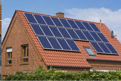
Figura 11 Sistema solar colocado encima de la cubierta. Fuente web.
