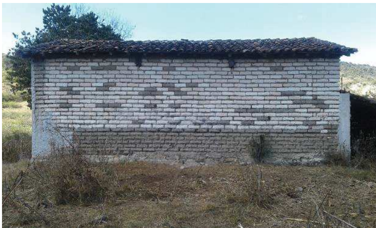
Figura 17. Fachada posterior, vivienda vernácula en abandono. Sta. Cruz Rancho Viejo, Oaxaca. Fuente: Fotografía del autor.
