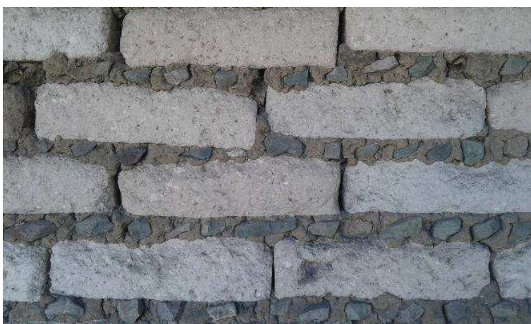
Figura 15. Muro de adobe, vivienda en abandono. Sta. Cruz Rancho Viejo, Oaxaca. Fuente: Fotografía del autor.
