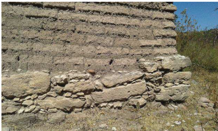
Figura 14. Uso de piedra en cimentación, vivienda en abandono. Sta. Cruz Rancho Viejo, Oaxaca. Fuente: Fotografía del autor.
