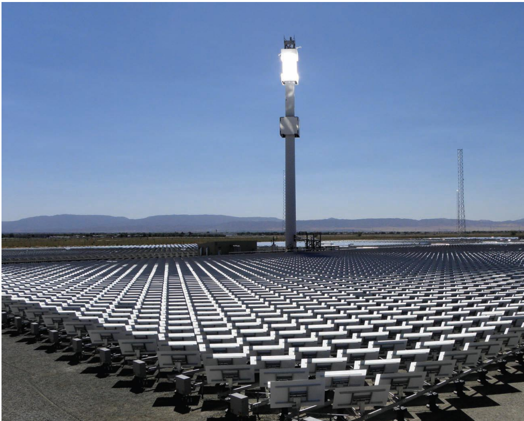
Figura 4. Planta termoeléctrica con tecnología de torre.
