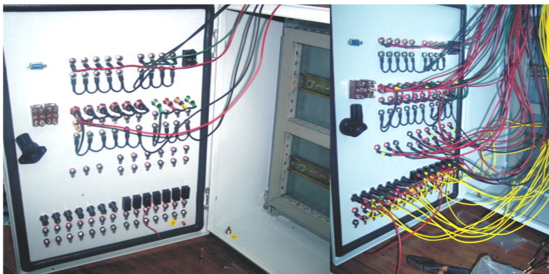
Figura 3. 13 Proceso de cableado del SAE-PLC y la implementación de terminales.
