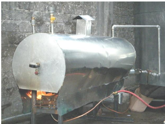
Figura 4.25: Equipo de gas L.P., terminado
