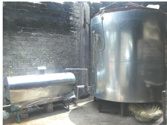
Figura 4.26: Equipo acoplado al horno en la línea de alimentación de vapor.
