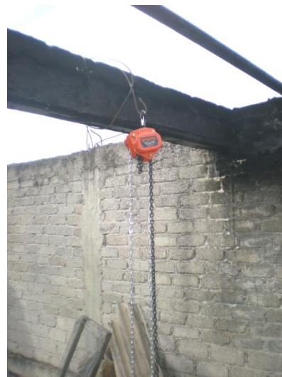
Figura 4.5: Polipasto para mover la carga en el campo
