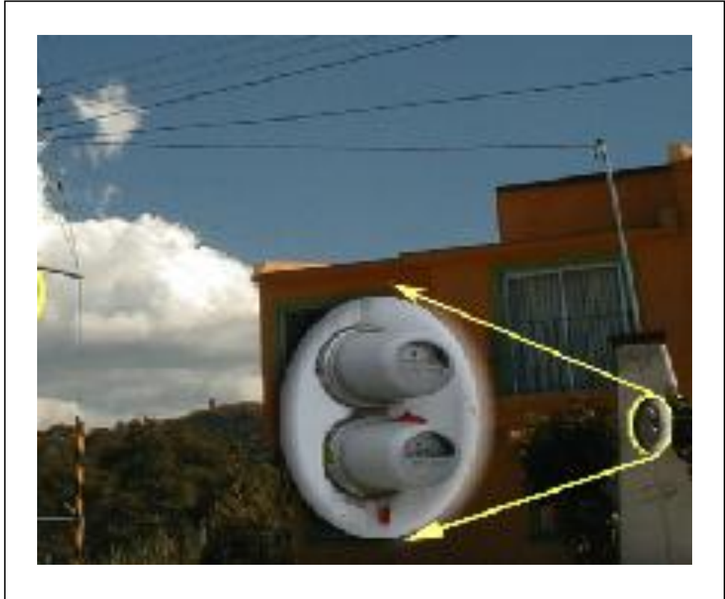
Figura 5.4 Medidores instalados en viviendas de la Unidad Habitacional.
